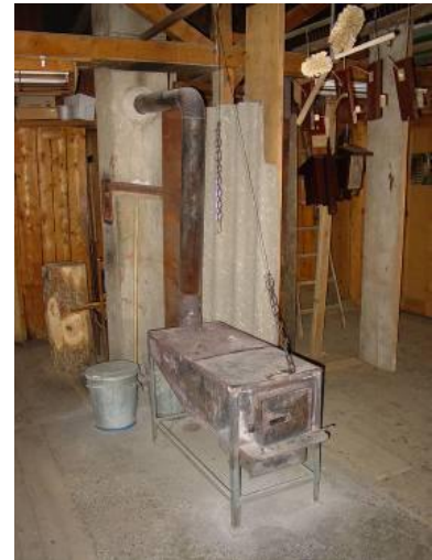
Holzofen zum Heizen
